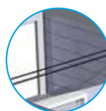
Tubazione del refrigerante
